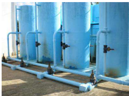
Estação de Tratamento de Água
